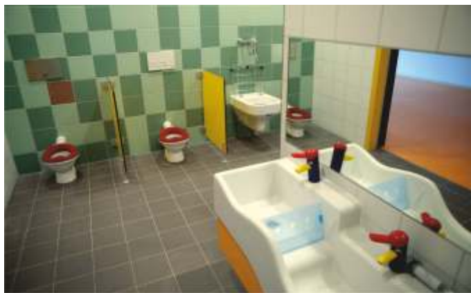
Moderne, zweckmäßige Sanitäranlagen befinden sich im ganzen Haus
